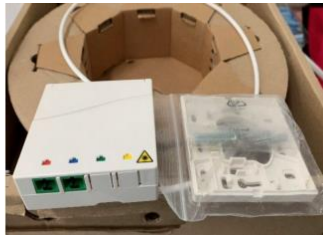
OTO und Gebäudeverkabelung
