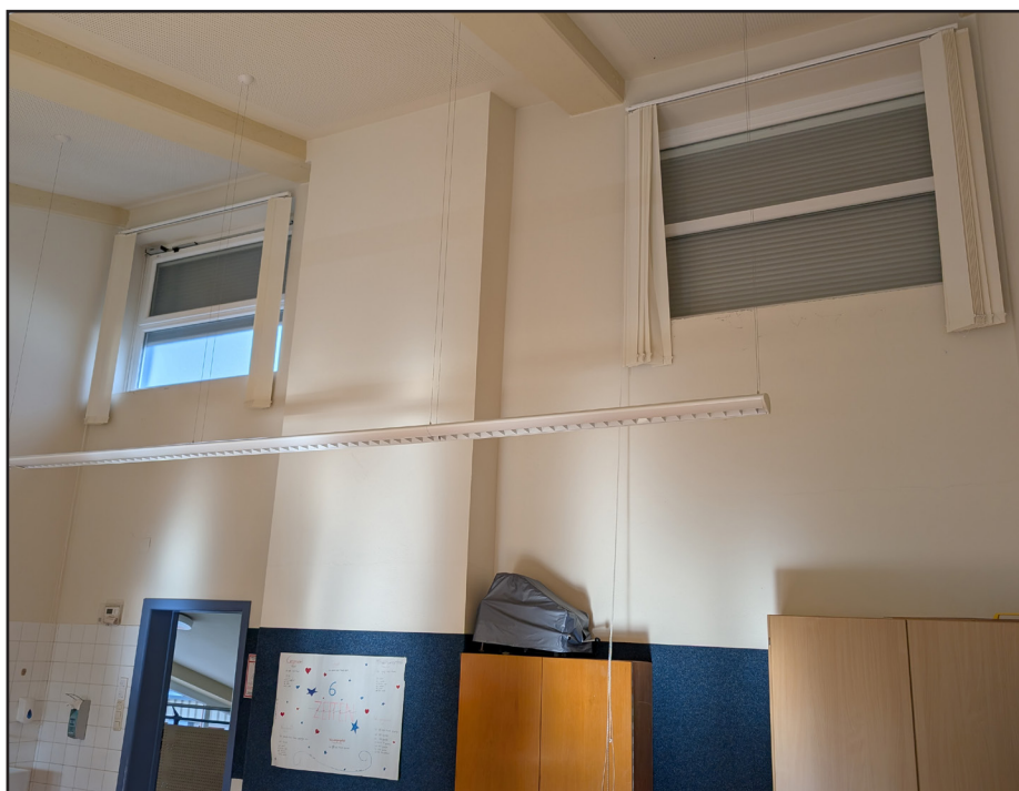
Die vier Klassenräume im Obergeschoss der Mittelschule erhielten einen Sonnenschutz
